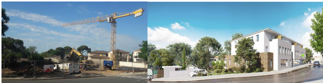
La zone de chantier du futur centre médical et logements et le bâtiment prévu pour 2023 ( source )
